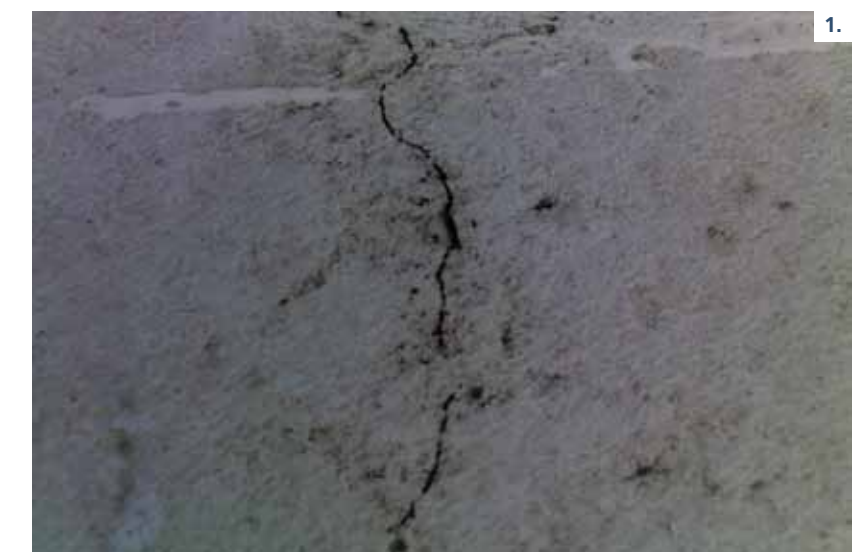
1. Las acciones mecánicas están directamente asociadas a la aparición de micro-fisuras, fisuras y fallas en el concreto.
